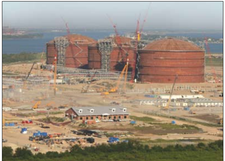
Sabine Pass LNG - October 2007
